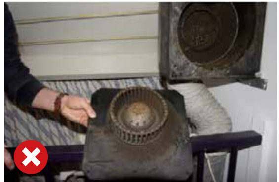
Sterk vervuilde ventilatie-unit zorgt voor minder vermogen, meer geluid en extra energiegebruik.
