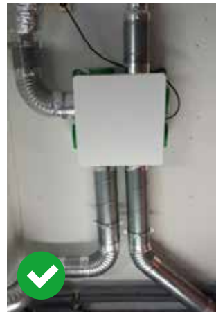
Een strak gemonteerde ventilatie-unit. Verbeterpunt: de bochten zijn niet glad vanbinnen waardoor extra luchtweerstand ontstaat.
